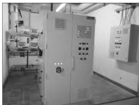
Elektrische Wärmepumpe Fabrikat: CombiTherm
